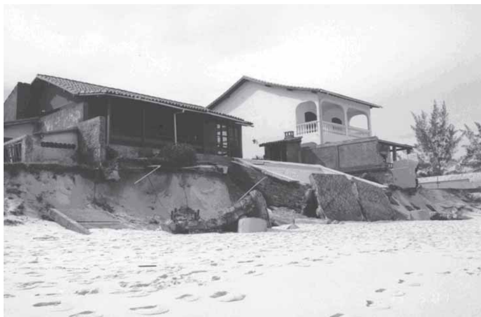
Figura 13. Erosão no trecho urbanizado em Barra de Maricá (RJ) por ação da tempestade de maio de 2001
